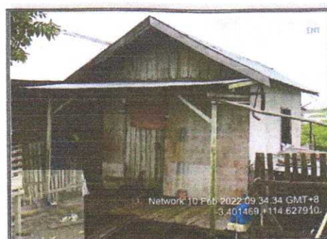
IDENTIFIKASI KERUSAKAN RUMAH AKIBAT BENCANA ALAM DESA PASAR KAMIS
